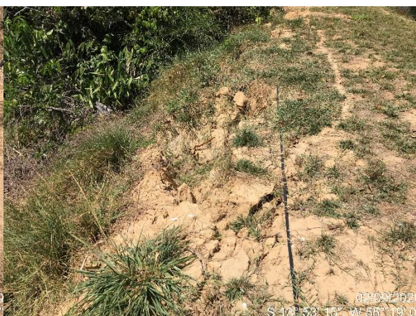
Figura 3 - Presença de ponto de escorregamento no talude de jusante
