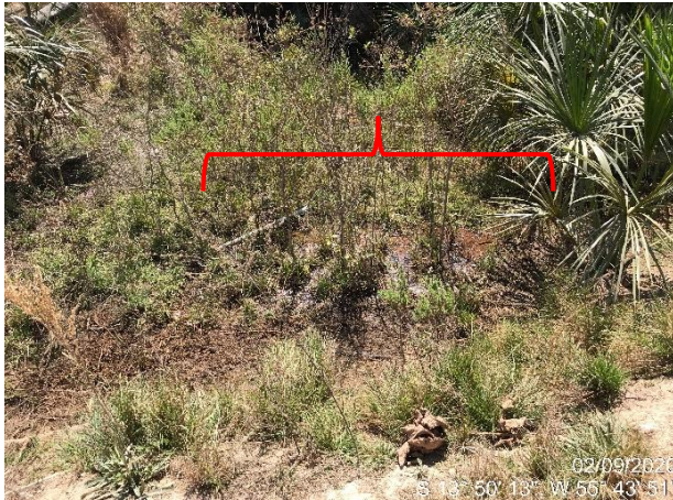
Figura 5 - Presença de surgência e/ou fuga d'água na região a jusante da barragem.
