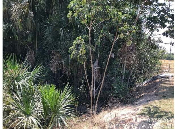
Figura 6 - Presença de vegetação ocupando toda a região a jusante da barragem.
