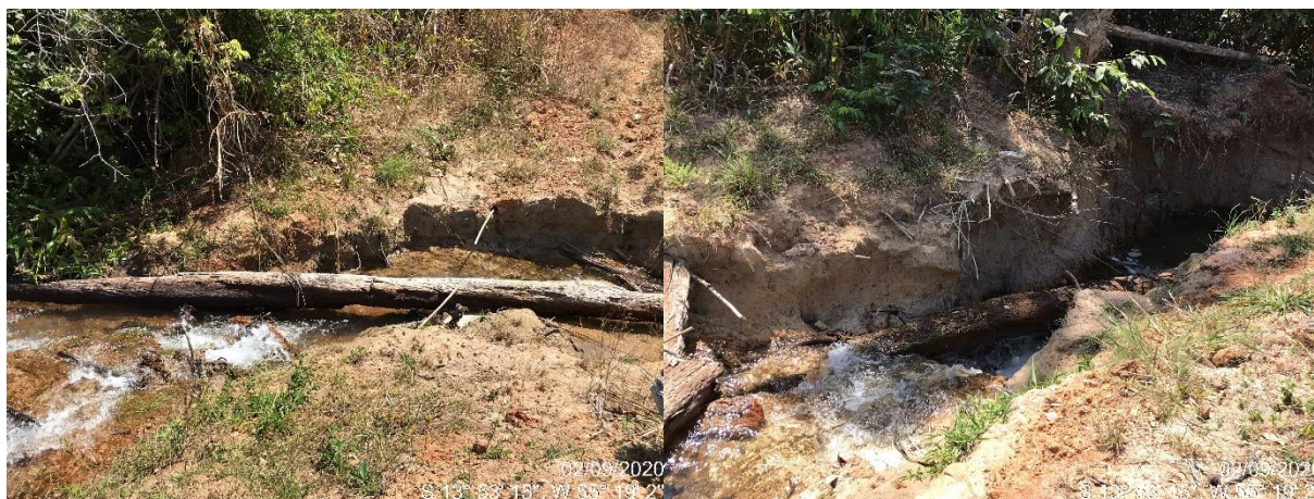
Figura 4 - Visão geral do canal extravasor após desbarrancamento.
