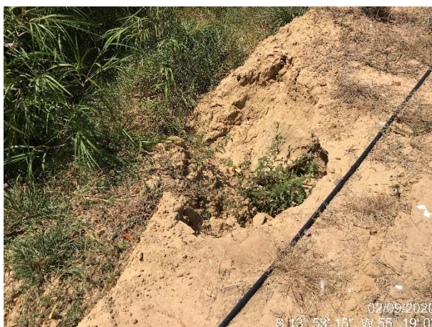
Figura 2 - Vista geral de formação de erosões na porção central do talude de jusante.
