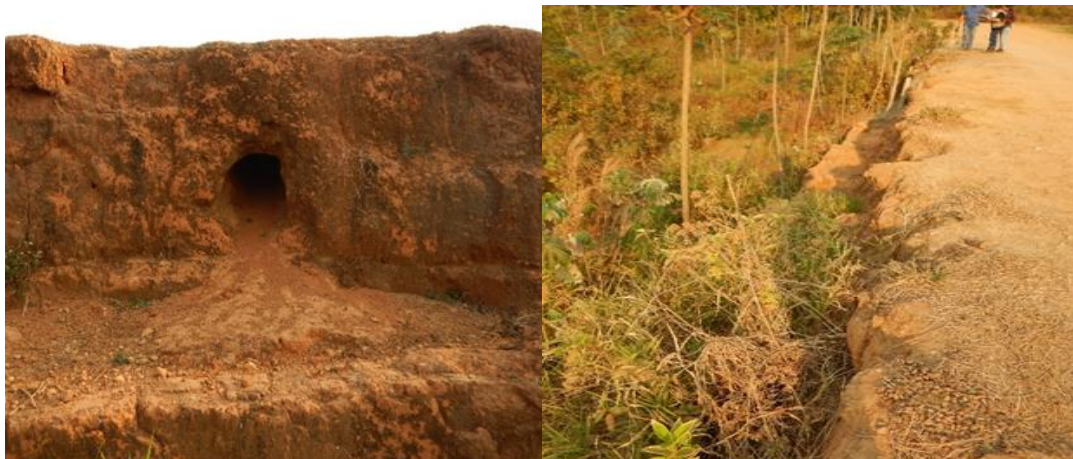
Figura 9 - Buraco de animais, erosões e vegetação no talude de jusante
